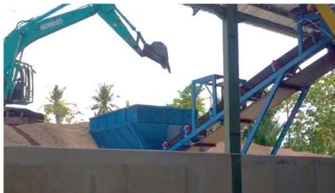
① 製錬工場ヤードから、大きな不純物除去ホッパー
